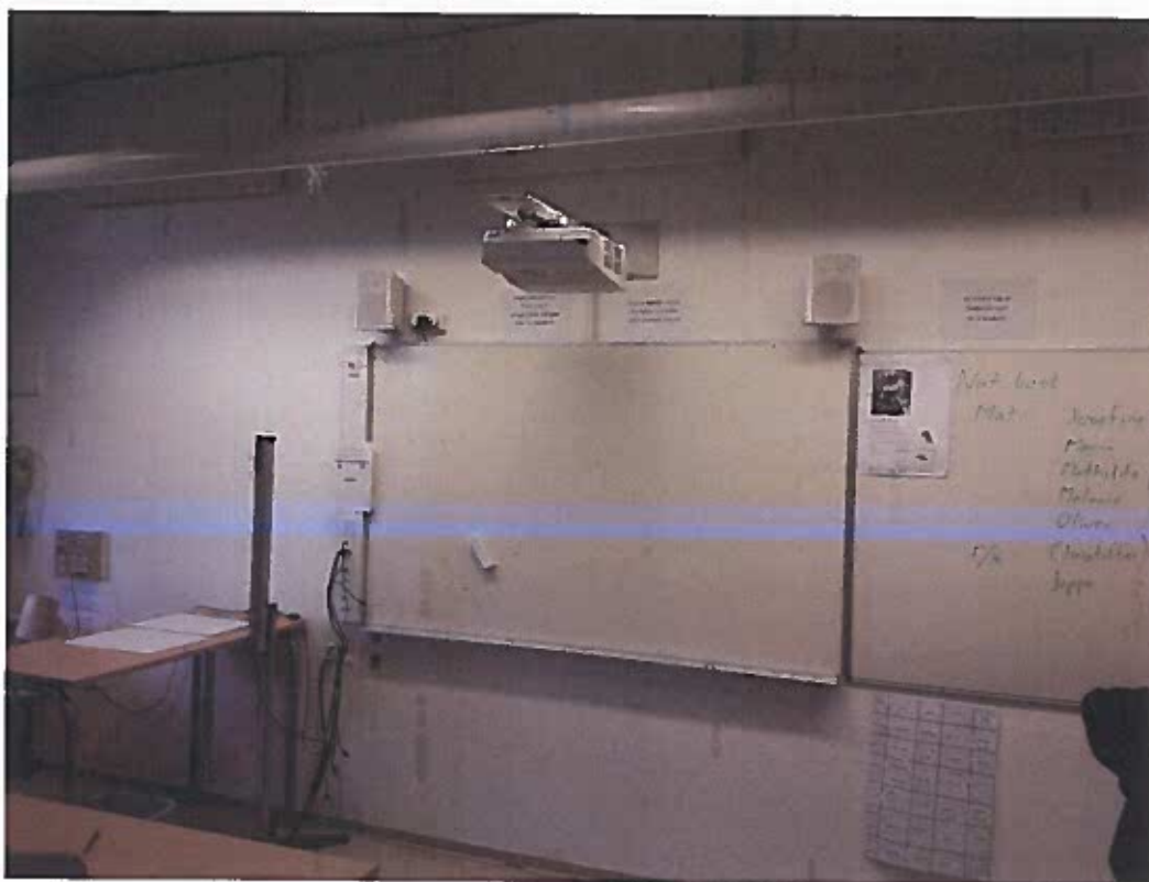
Der hænger et lysarmatur i omtrent 2,5 meters højde i lokalet.
